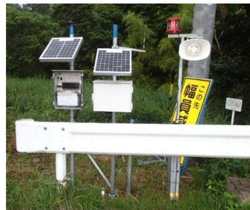
緊急事態に備え、24時間監視システムを設置
