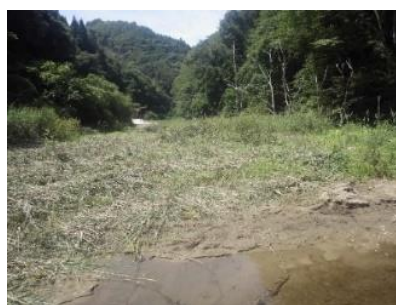
土砂が堆積した砂防堰堤
