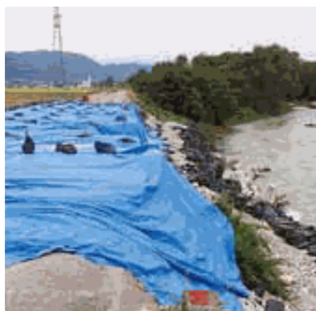
7月の集中豪雨により、高瀬川の堤防が欠損して大災害寸前の池田町の現場
