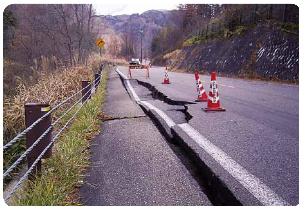
地震による亀裂
