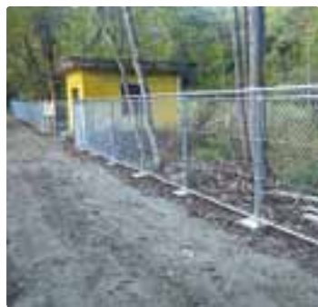
新しく柵が完成した居谷里水源。 まだサルの出入りは可能
