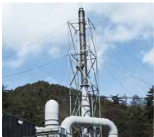
一向に環境改善につながらない高くした排気塔
