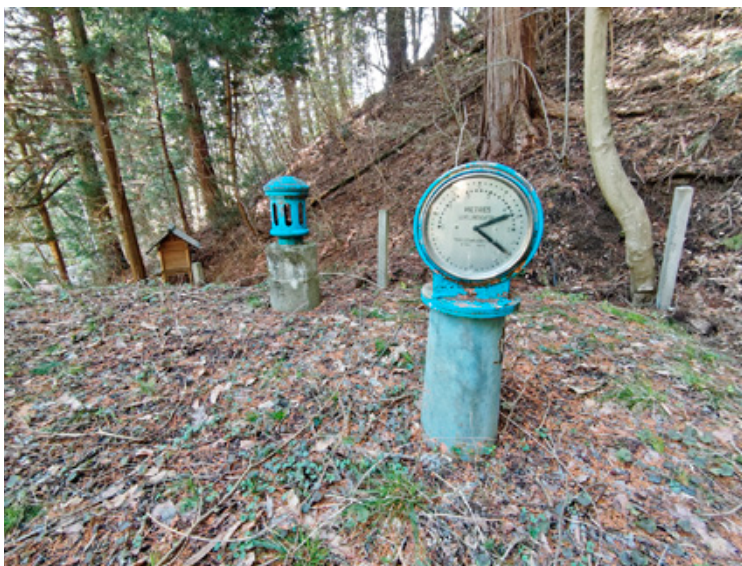
宮本配水池に残る宮本水道の水位計
