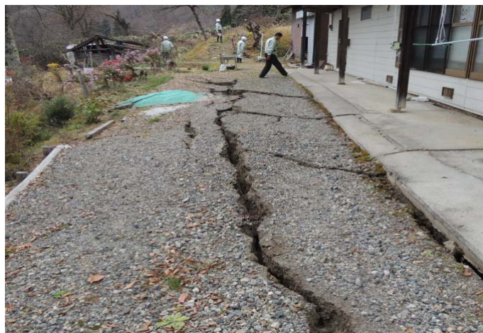
長野県神城断層地震被害 (大町市美麻地区)
