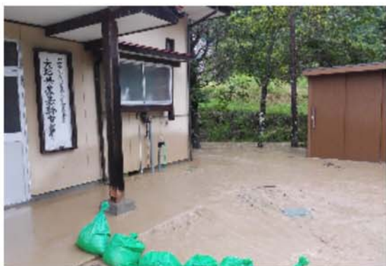
①大塩 集落基幹センター床下浸水(7/8撮影)
