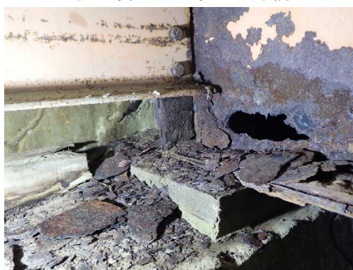
健全度Ⅳ：一字田1号橋
